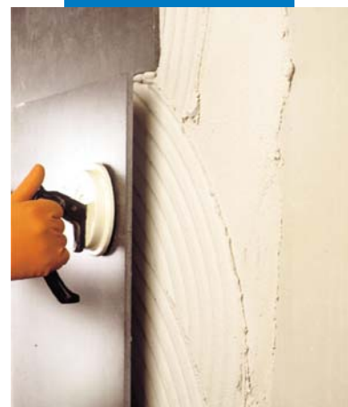
Полагане на големи по размер порцеланови плочки върху бетонна фасада с Elastorapid
